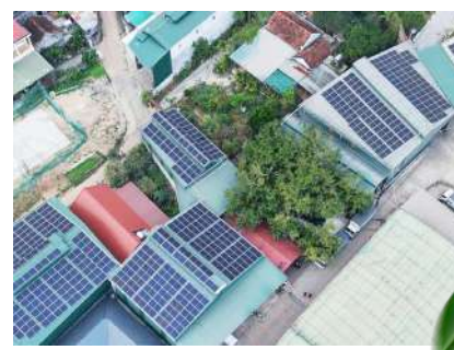
Công trình cho nhà xưởng 250kWp tại Nghệ An
