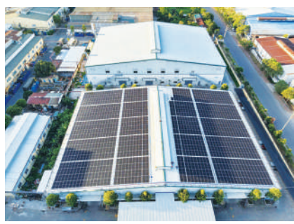
Công trình cho nhà xưởng sản xuất phích nước & thủy tinh 1,5MWp tại Quế Võ, Bắc Ninh
