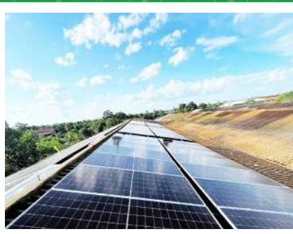
Công trình cho trang trại 100kWp tại Hà Nội
