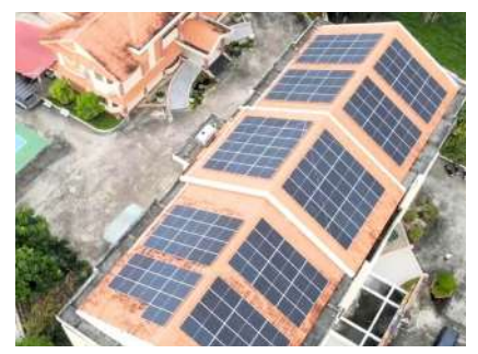
Công trình cho Trụ sở hành chính 100kWp tại Tây Ninh
