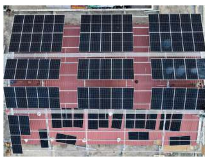
Công trình cho Trụ sở hành chính 100kWp tại Nha Trang
