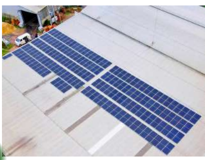
Công trình nhà xưởng 100kWp tại Tây Nguyên
