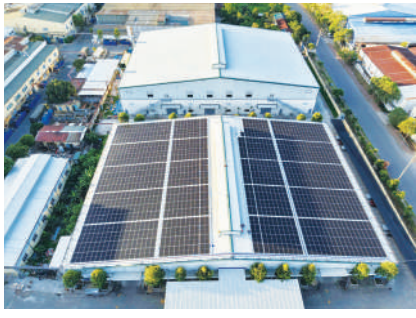
Công trình cho nhà xưởng sản xuất phích nước & thủy tinh 1,5MWp tại Quế Võ, Bắc Ninh
