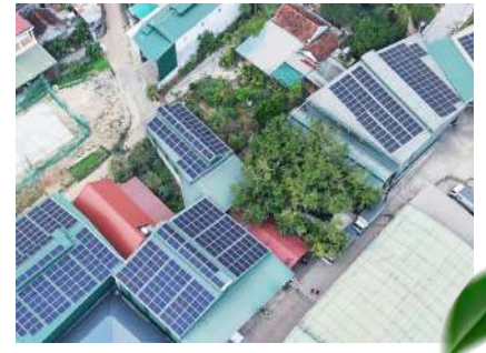
Công trình cho nhà xưởng 250kWp tại Nghệ An
