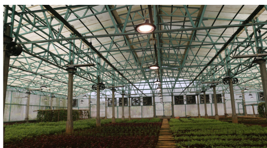
Chiếu sáng Smart Farm tại Hòa Bình
