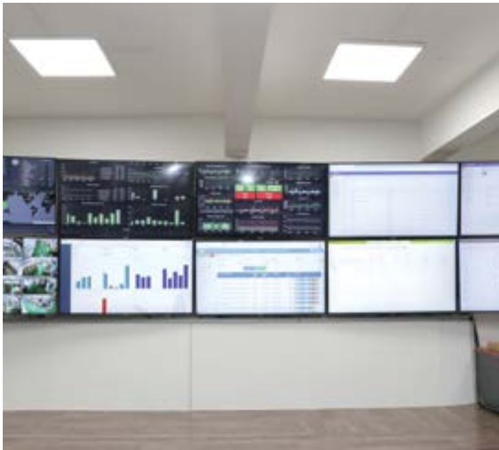
Trung tâm điều hành số Xưởng LED ĐT&TBCS
