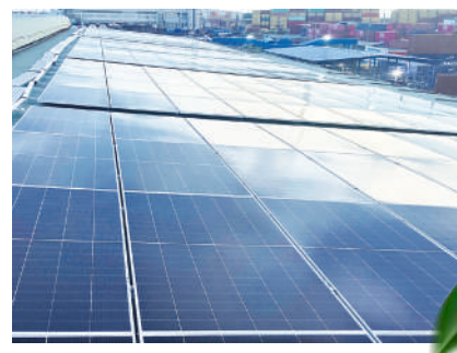
Công trình cho nhà xưởng 900kWp tại Hải Phòng
