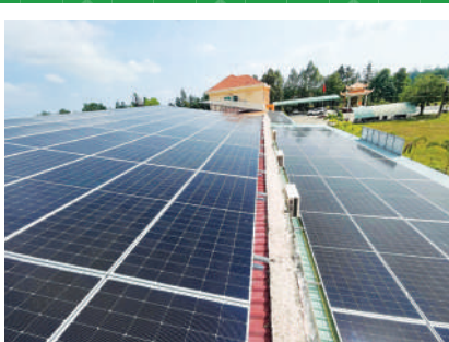
Công trình cho Trụ sở hành chính 80kWp tại Bình Hòa, Tây Ninh
