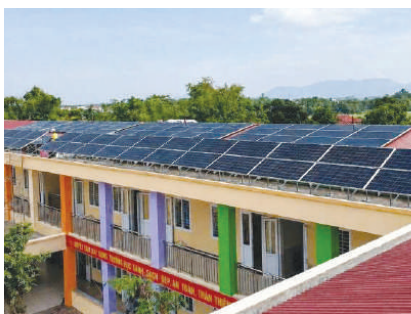
Công trình cho trường học 150kWp tại Hà Nội
