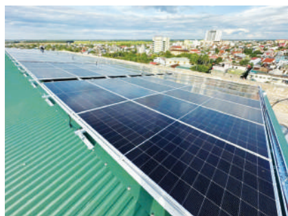
Công trình cho Trụ sở hành chính 160kWp tại Đông Hà, Quảng Trị
