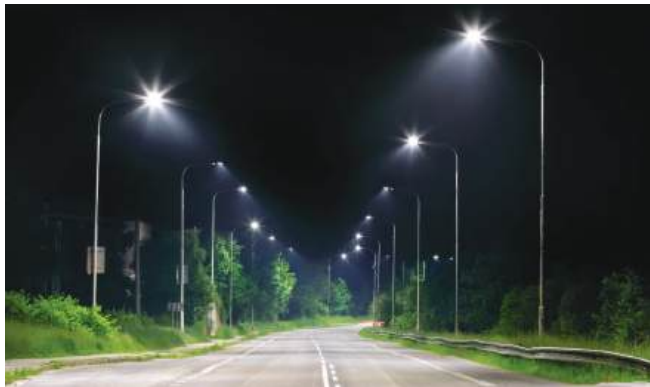
Cải tạo hệ thống chiếu sáng TP. Hưng Yên
