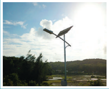
Dự án đèn đường IoT Cô Tô, Quảng Ninh
