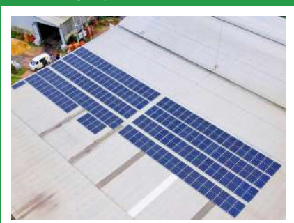
Công trình nhà xưởng 100kWp tại Tây Nguyên
