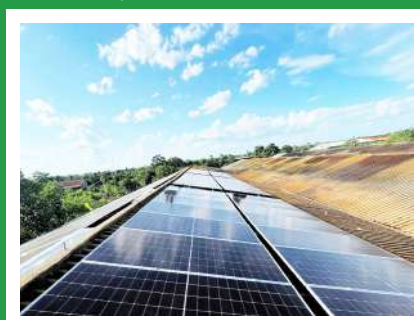
Công trình cho trang trại 100kWp tại Hà Nội
