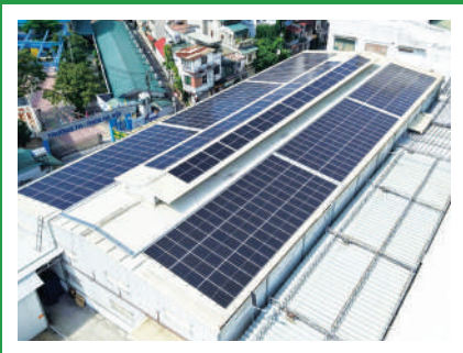
Công trình cho nhà xưởng 230kWp tại Hà Nội
