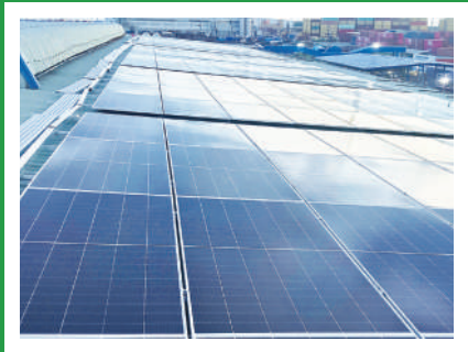
Công trình nhà xưởng 900kWp tại Hải Phòng
